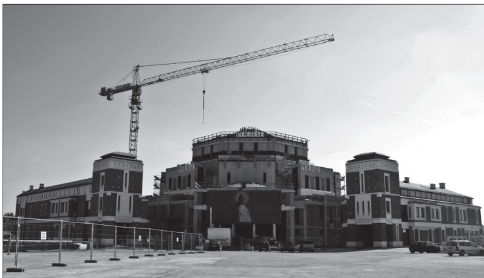
Fot. 2. Centrum Jana Pawła II „Nie lękajcie się” w trakcie budowy, wrzesień 2012 r. (fot. Justyna Liro)
